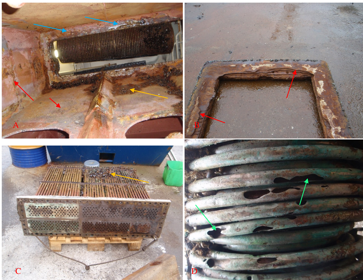
Figur 19. Demontering av bokskjøler fra sjøkiste viser korrosjon og marin begroing (→) og korrosjon (→), korrosjon på ramme i karbonstål (→) sett fra (A): undersiden og (B): oversiden, (C): Demontert bokskjøler, (D): Korroderte hull i varmevekslerrørene
